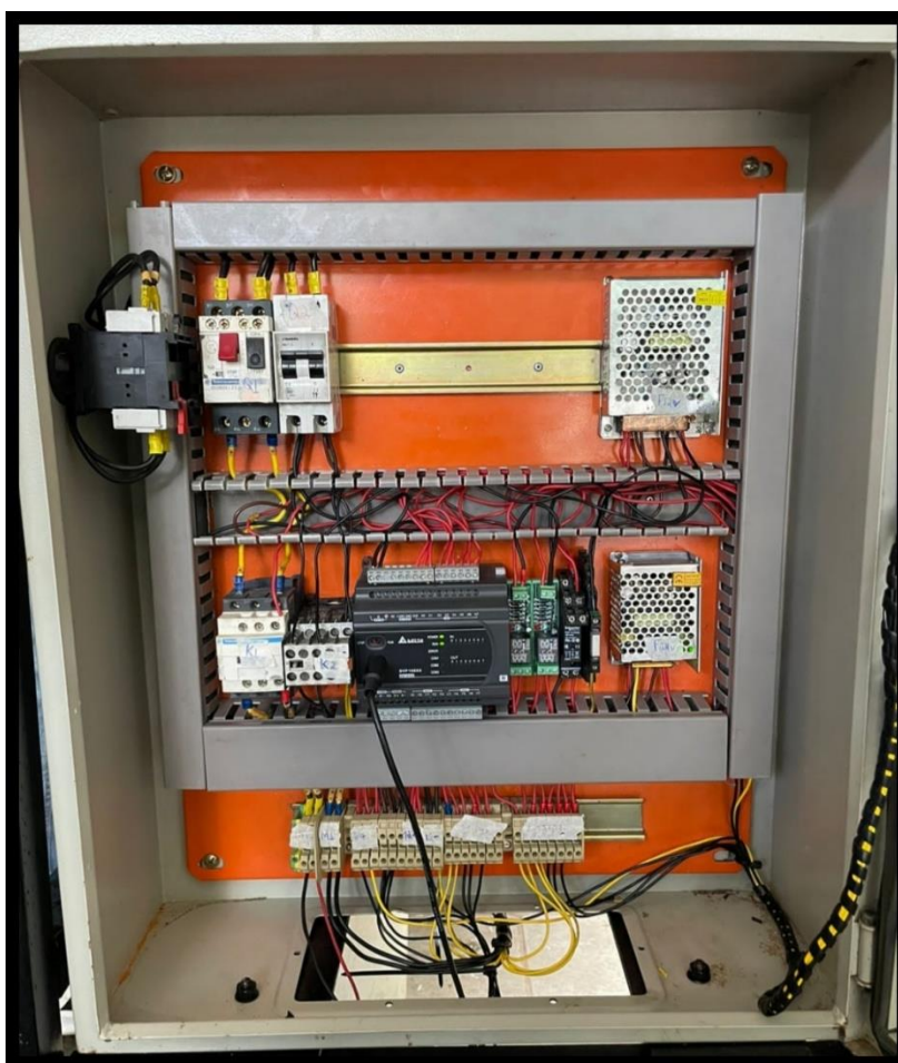
Figura 3.11 – painel elétrico concluído
