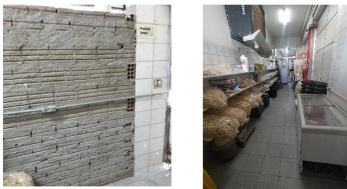
Figura 2 – Parede sem azulejo na panificadora, antes e depois.
