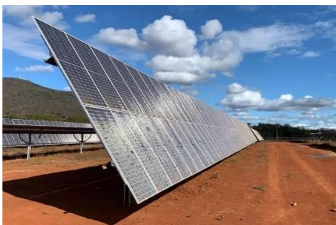
Figura 51 - Usina Solar Capitão Enéas.
