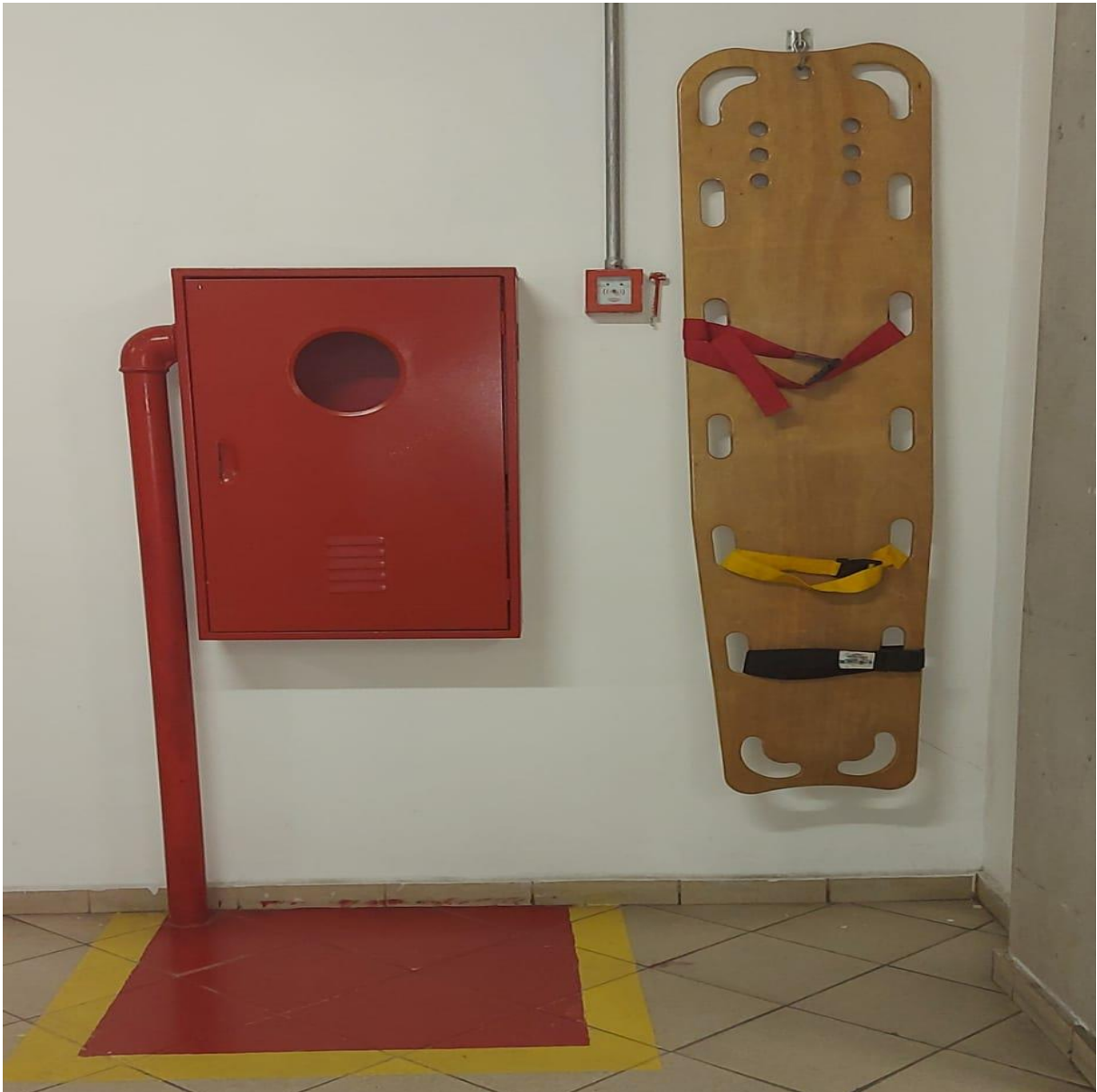
Figura 9: quadro do hidrante
