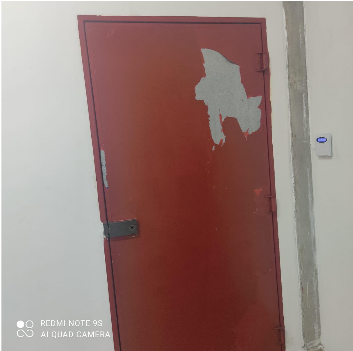
Figura 3: Porta corta fogo/saída de emergência
