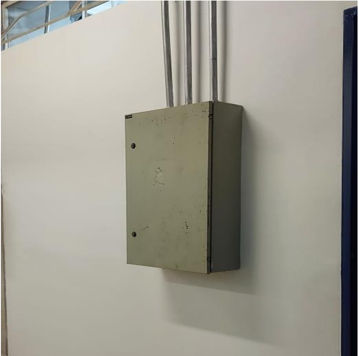
Figura 10: quadro do energia
