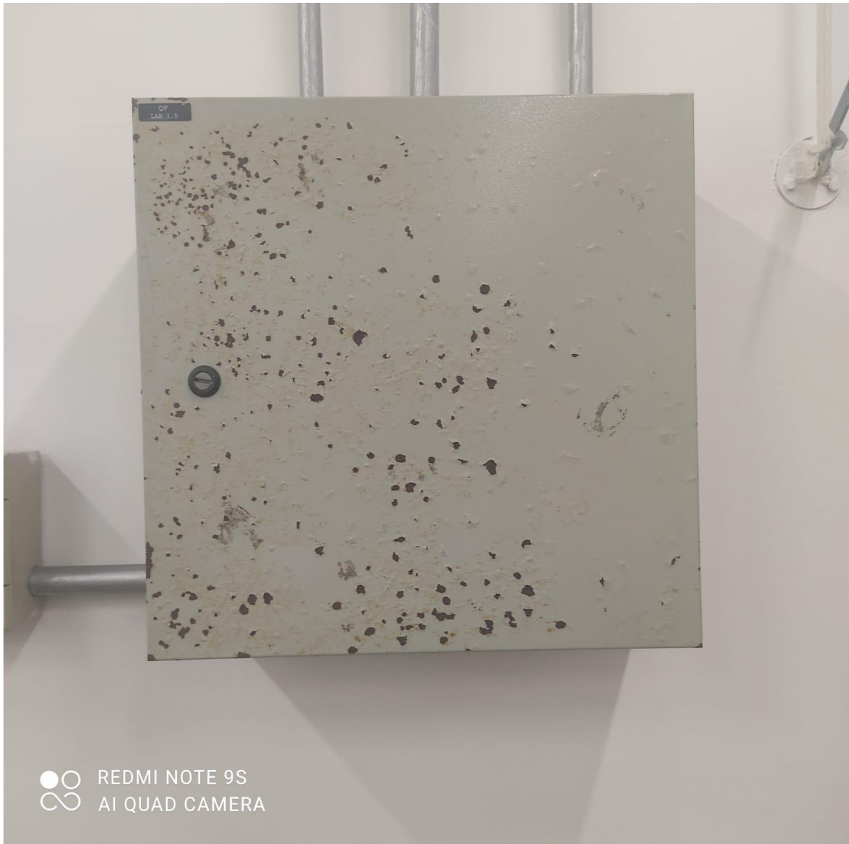
Figura 16: quadro de energia.
