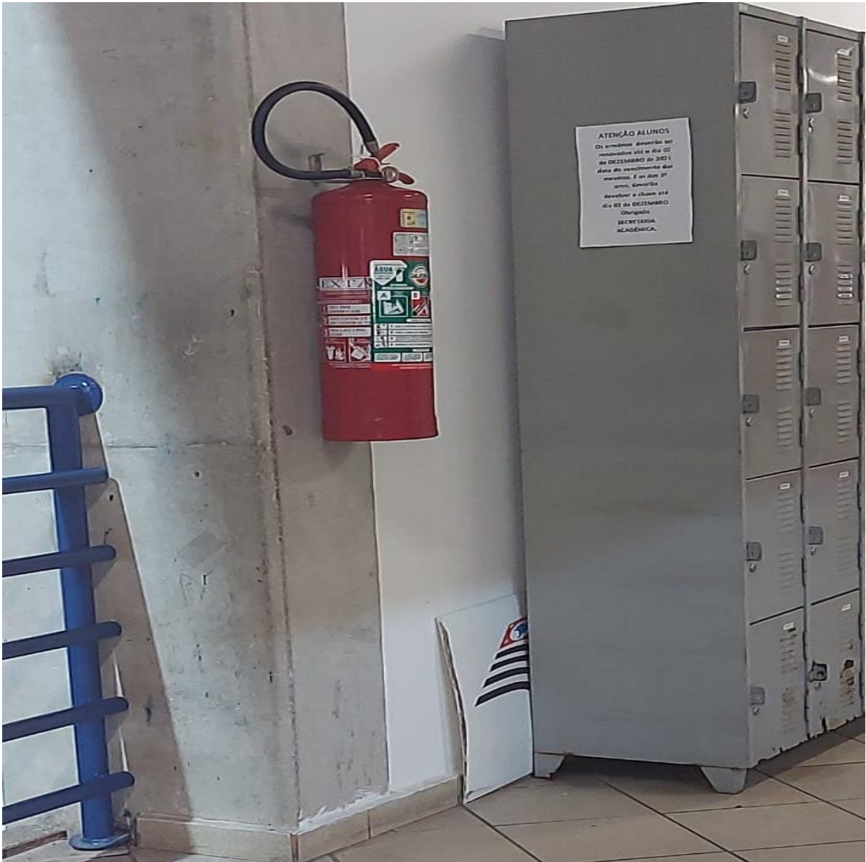
Figura 8: extintor de incêndio
