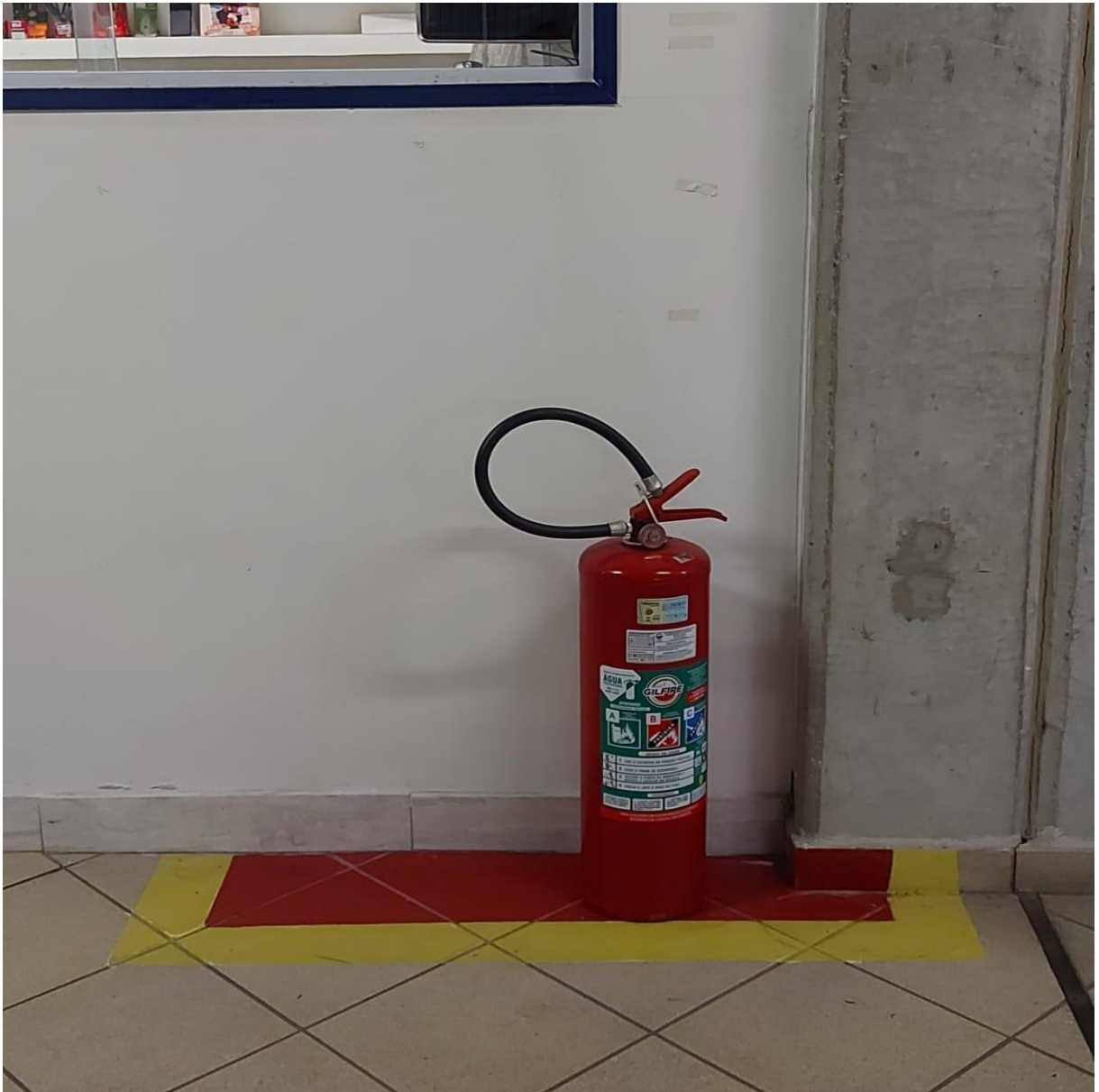
Figura 2: Extintor de incêndio no chão
