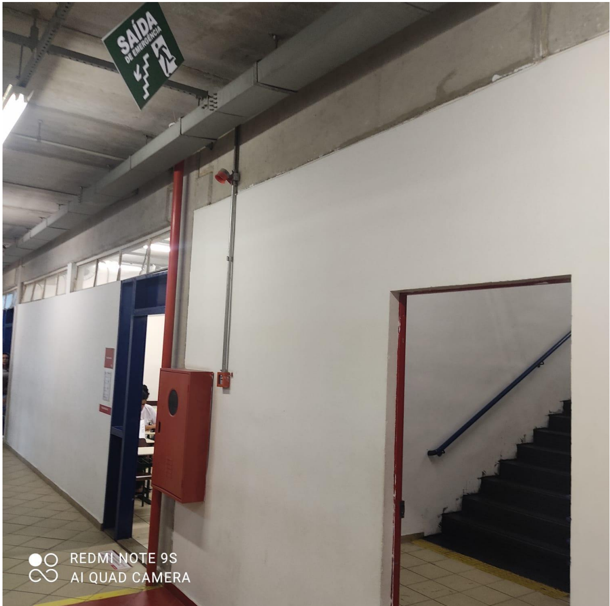
Figura 4: Placa de sinalização de saída de emergência
