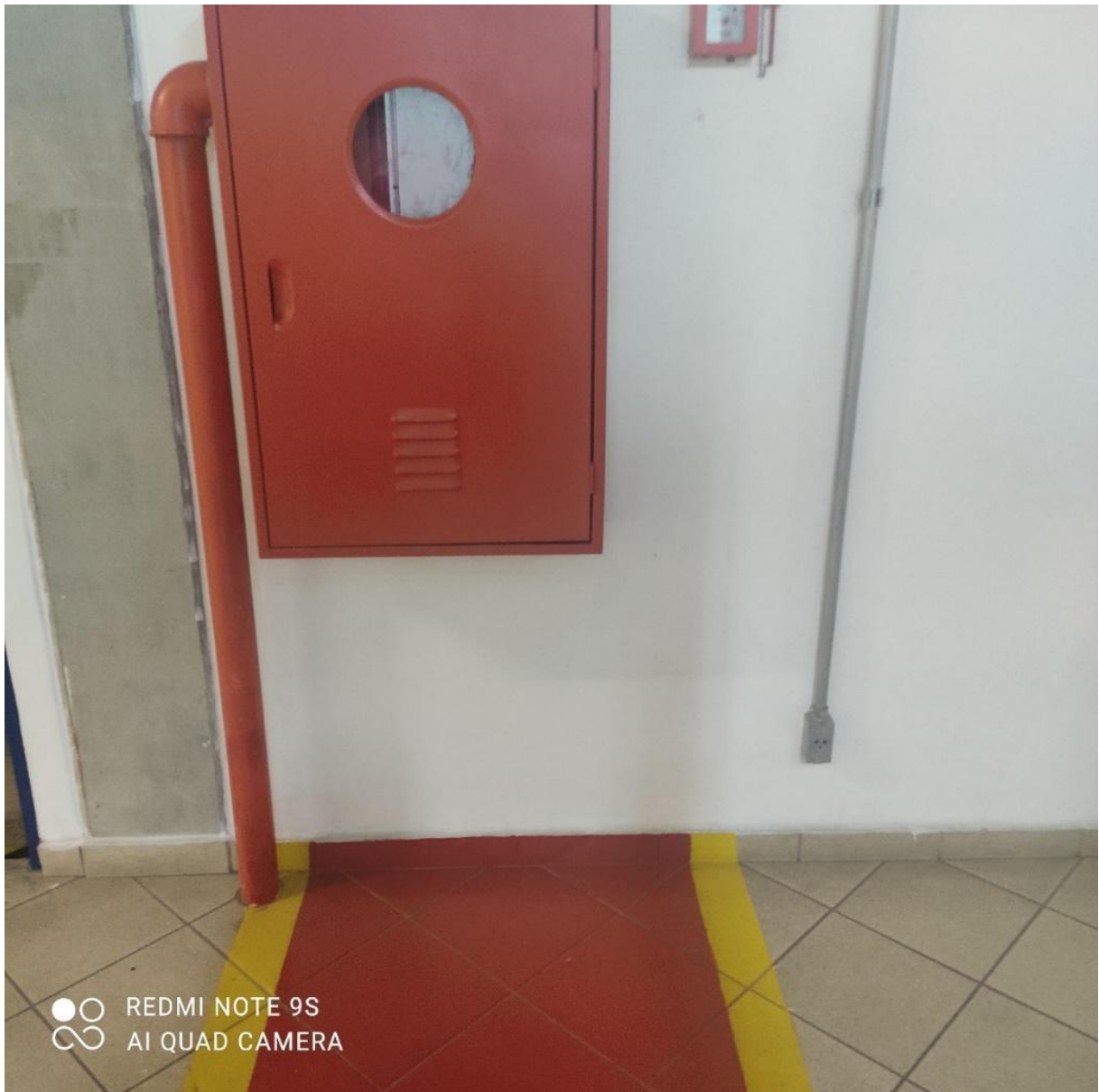
Figura 1: Quadro de Hidrante.
