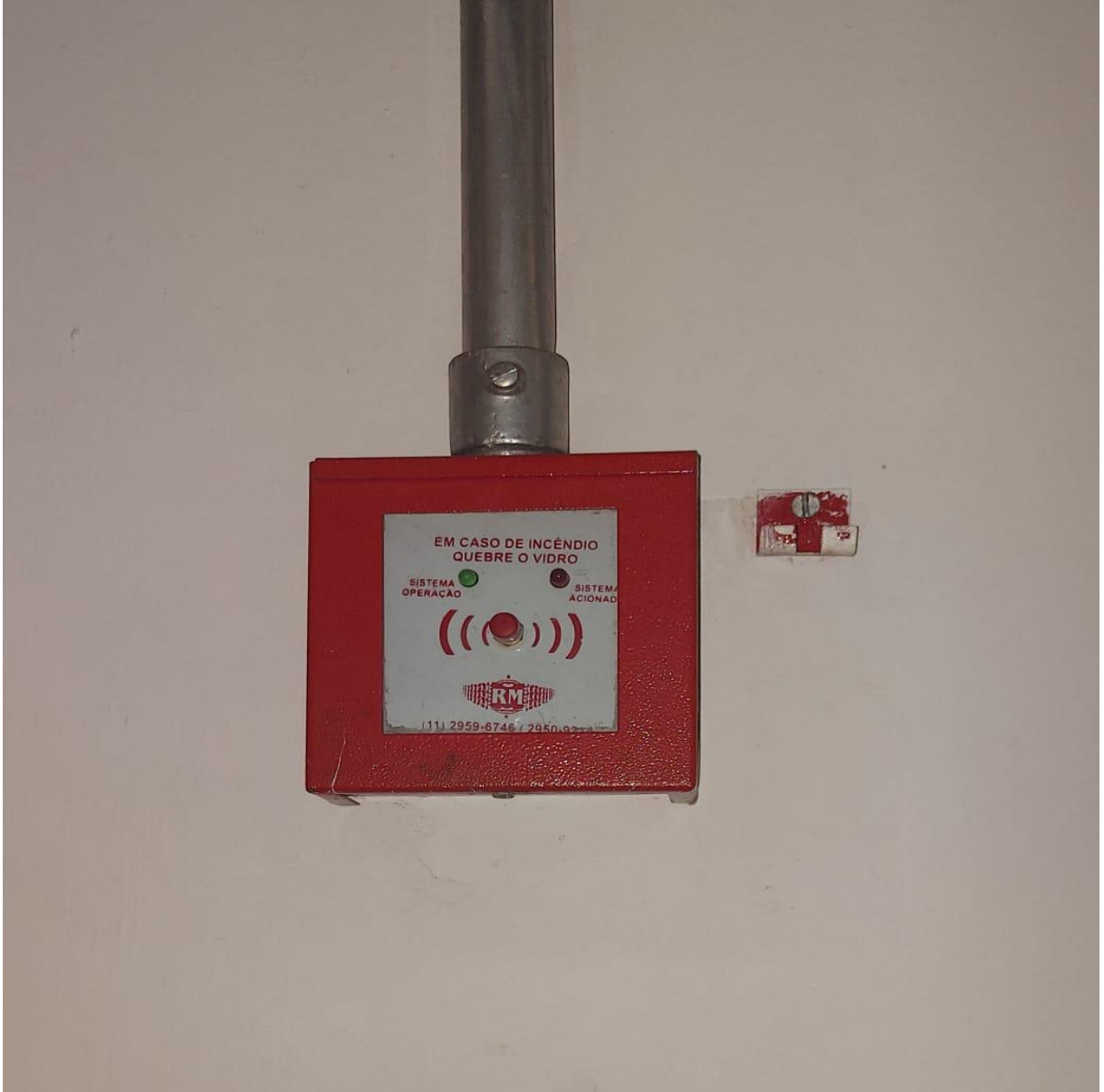
Figura 6: Botoeira de alarme de incêndio
