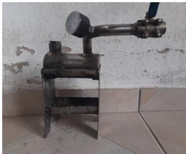
Figura 19: Manômetro e registros soldados na caldeira.
