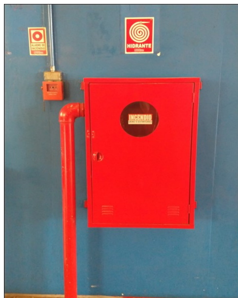
Figura 2: Equipamento Brigada de Incêndio
