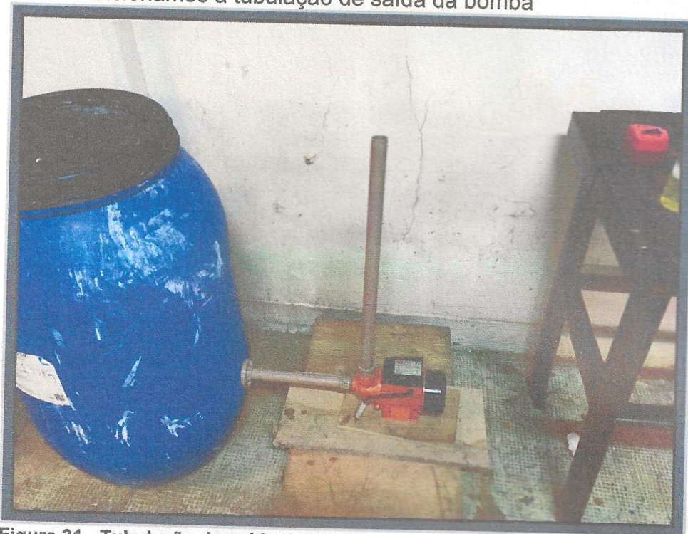
Figura 31 - Tubulação de saída da bomba
