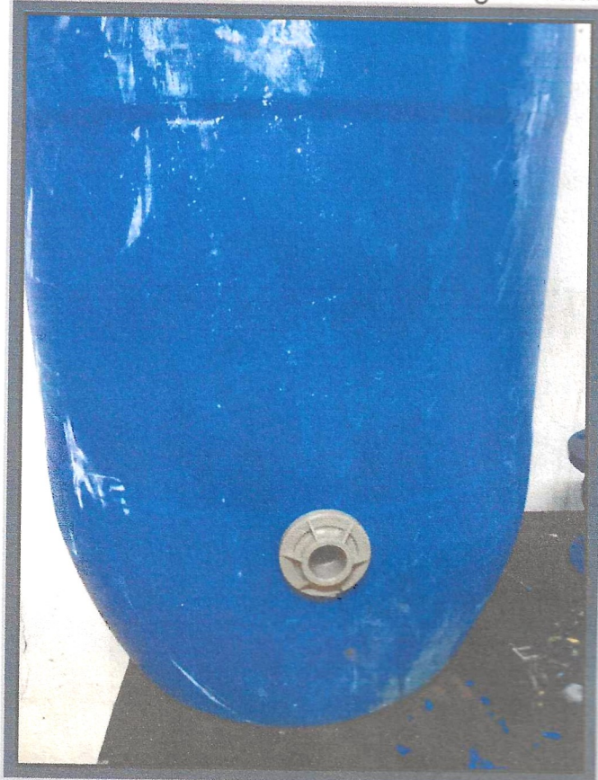
Figura 27 - Flange instalada no primeiro recipiente
