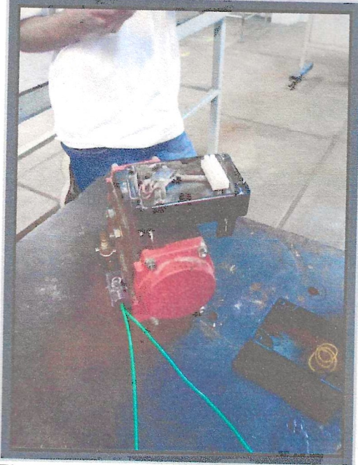
Figura 12 – Manutenção da válvula eletropneumática
