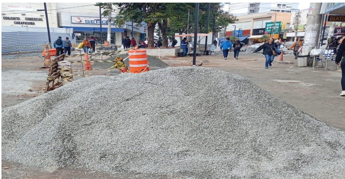
Figura 1 – Materiais de construção ocupando a área de circulação de pedestres.
