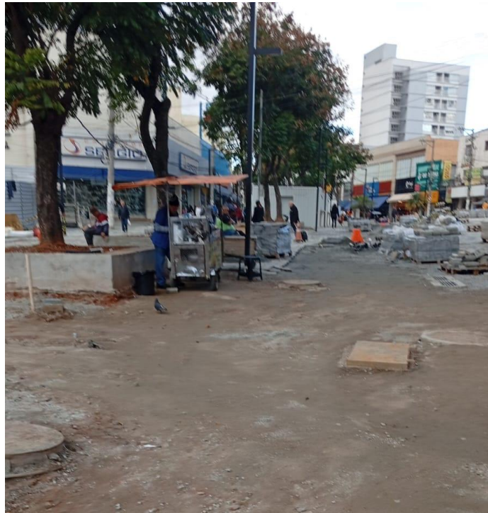
Figura 3 – Obstáculos temporários e irregularidades no pavimento.
