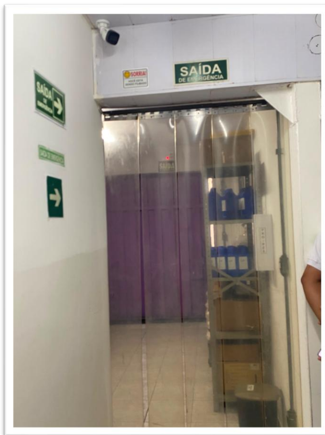
Figura 6. Exemplo de corredor industrial com rotas de emergência sinalizadas.
