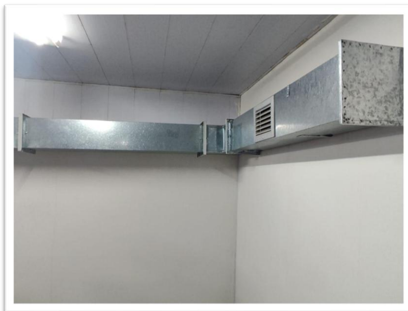
Figura 5. Tubulação para exaustão de álcool etílico.
