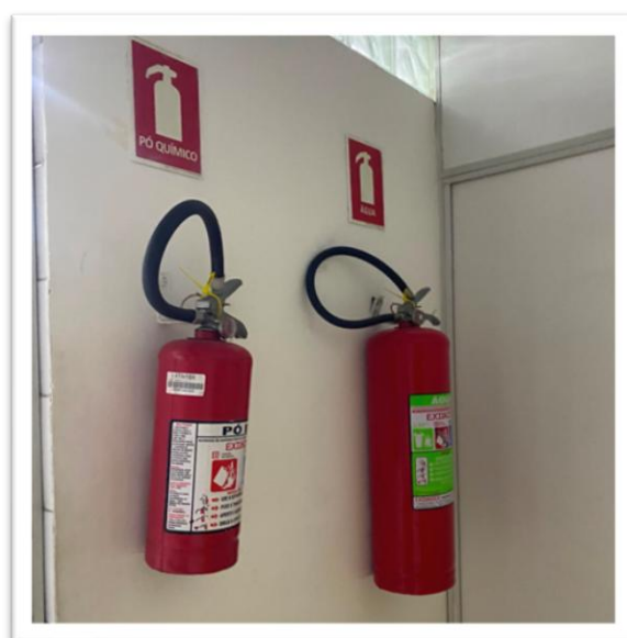
Figura 10. Equipamento de combate a princípio de incêndio em área produtiva da fábrica.
