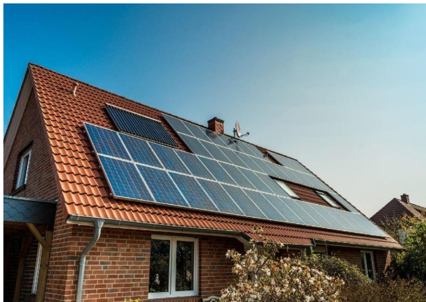
Imagem 1 – Paine Solar Fotovoltaico
