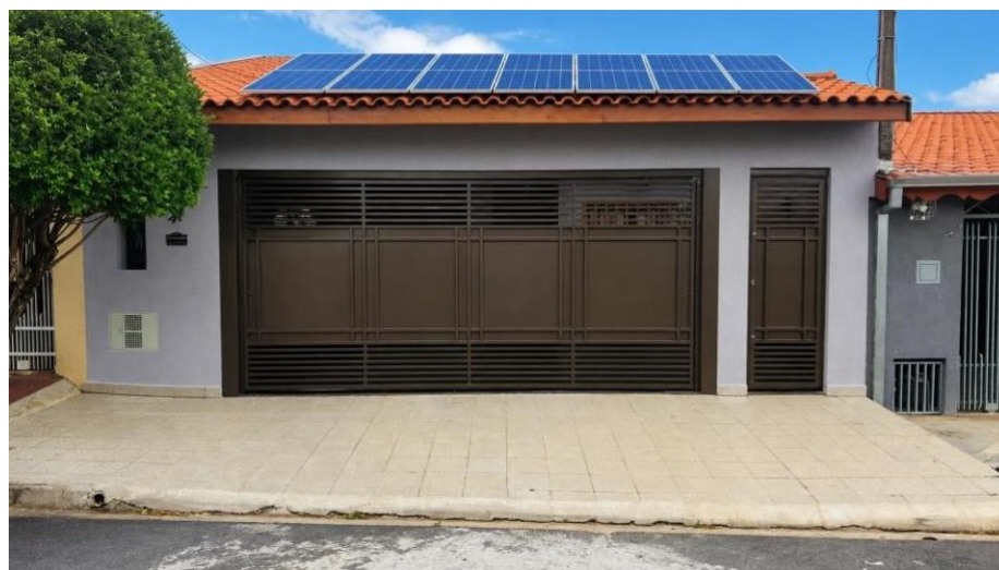
Imagem 11 – Imagem ilustrativa da fachada principal com Painéis Fotovoltaicos.
