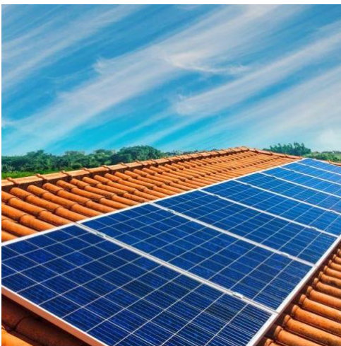
Imagem 1 – Painel Solar Fotovoltaico
