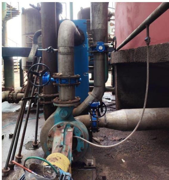
Figura 5 - Recirculação das dornas (válvula manual)
