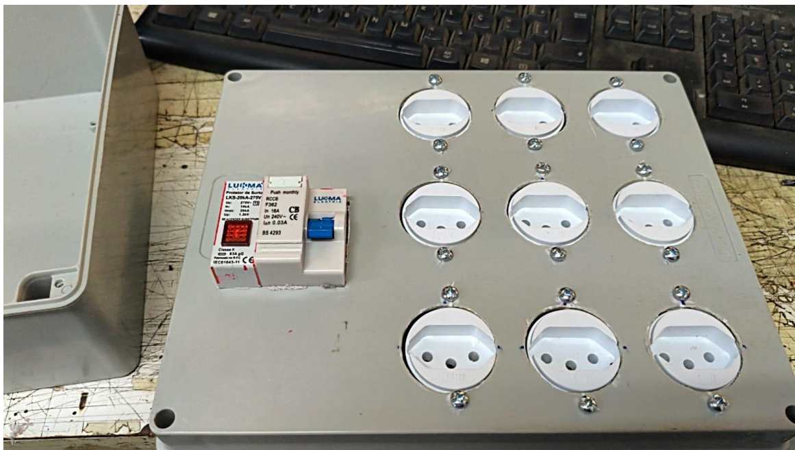
Figura 10: Visão frontal do sistema de proteção e distribuição de circuito com as tomadas instaladas e os dispositivos de proteção (IDR e DPS) embutidos nela.
