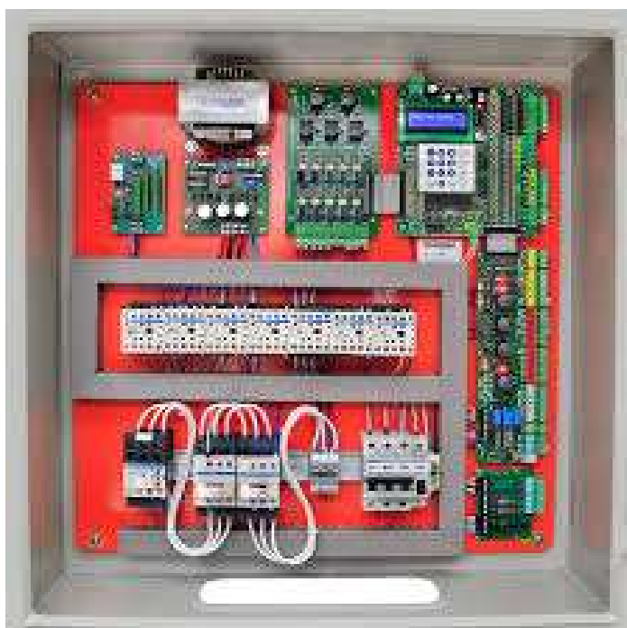
Figura 9- Imagem do quadro de comando
