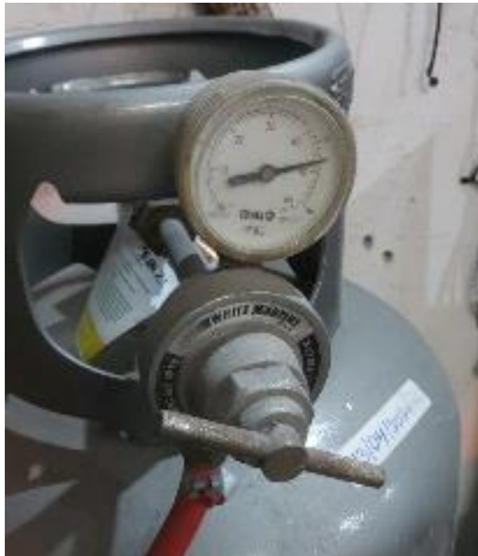
Figura 29 – Regulador manômetro gás GLP
