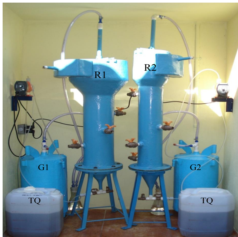
Figura 3- Representação esquemática (A) e foto do sistema de tratamento com os reatores anaeróbios UASB (R1 e R2) (B). TQ – Tanque de armazenamento de afluente, G1 e G2 – Gasômetros do R1 e R2.
