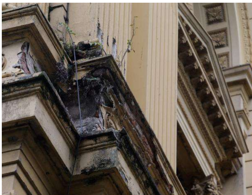
Foto 3: Museu do Ipiranga tem sinais de deterioração em sua fachada.
