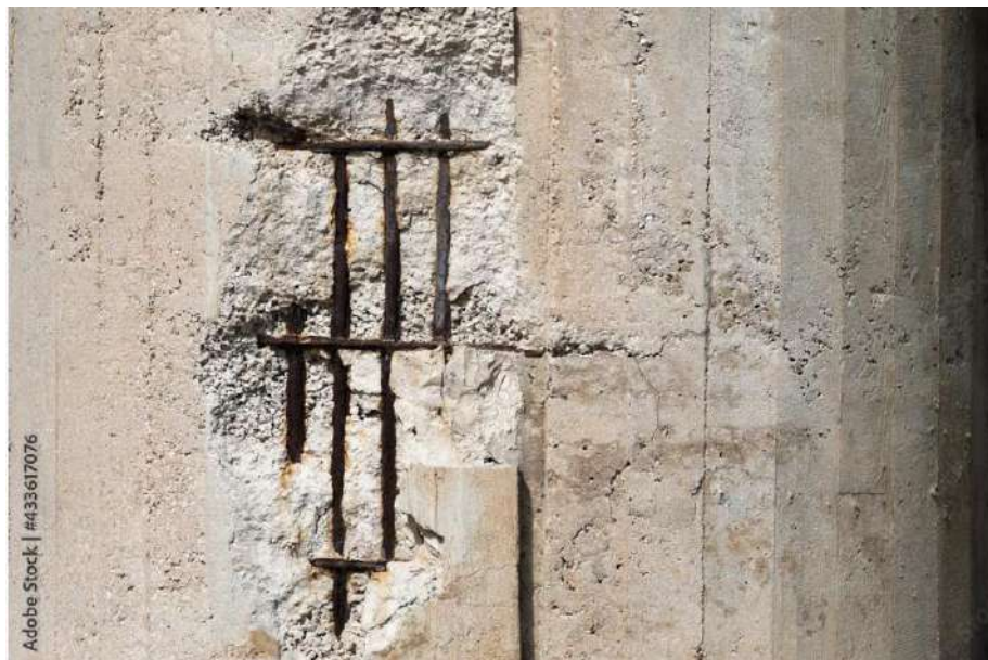
Foto 1: Câncer de Concreto de SJP Stock
