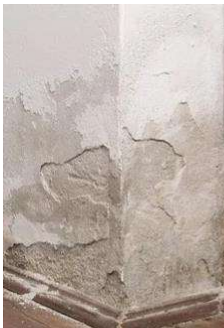
Foto 2: Infiltração por umidade ascendente.
