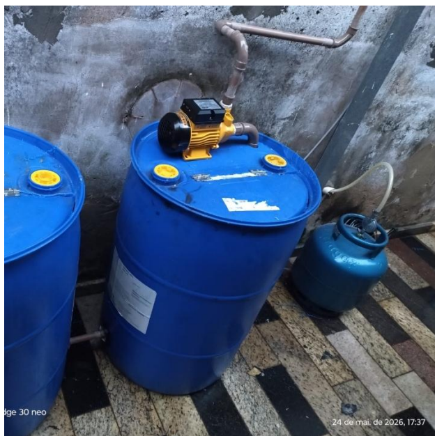
Figura 4 – Bomba de Recalque ao reservatório 3
