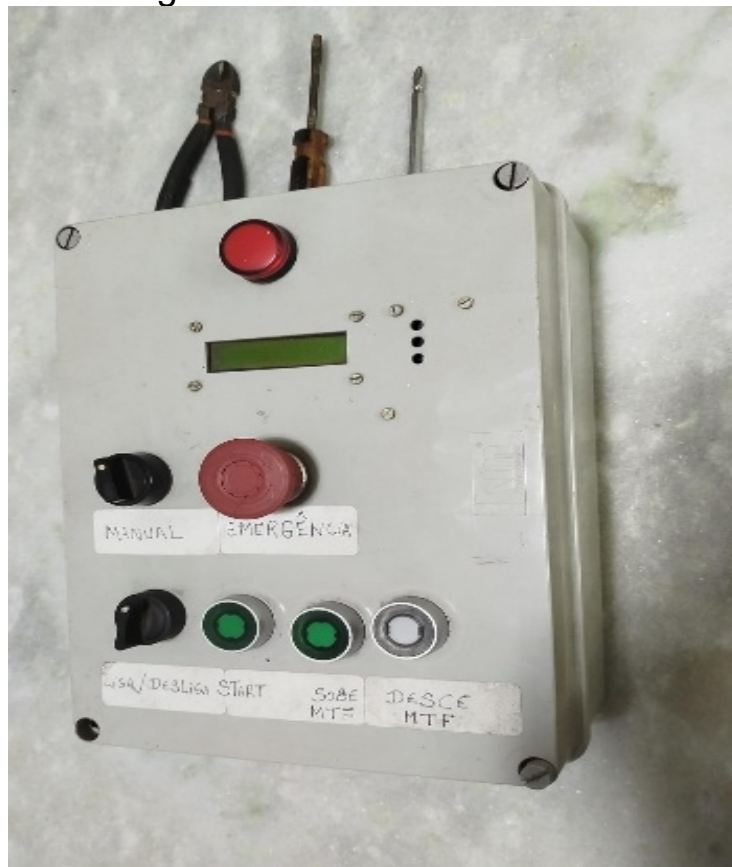
Figura 2 – Painel de comando
