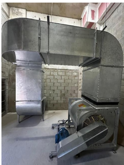
Figura 12 - Vista Lateral da rede de Dutos
