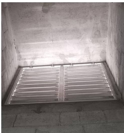
Figura 14 - Vista Interna do Damper de Sobrepressão
