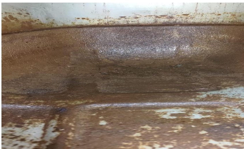
Figura 5: Tanque de combustível oxidado pela presença de água
