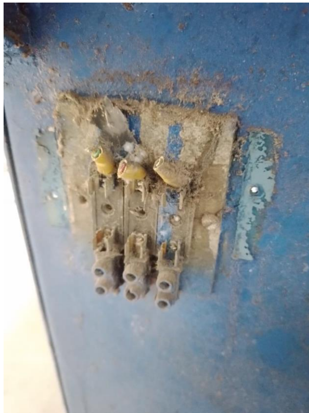
Figura 7 - Antigos fusíveis térmicos
