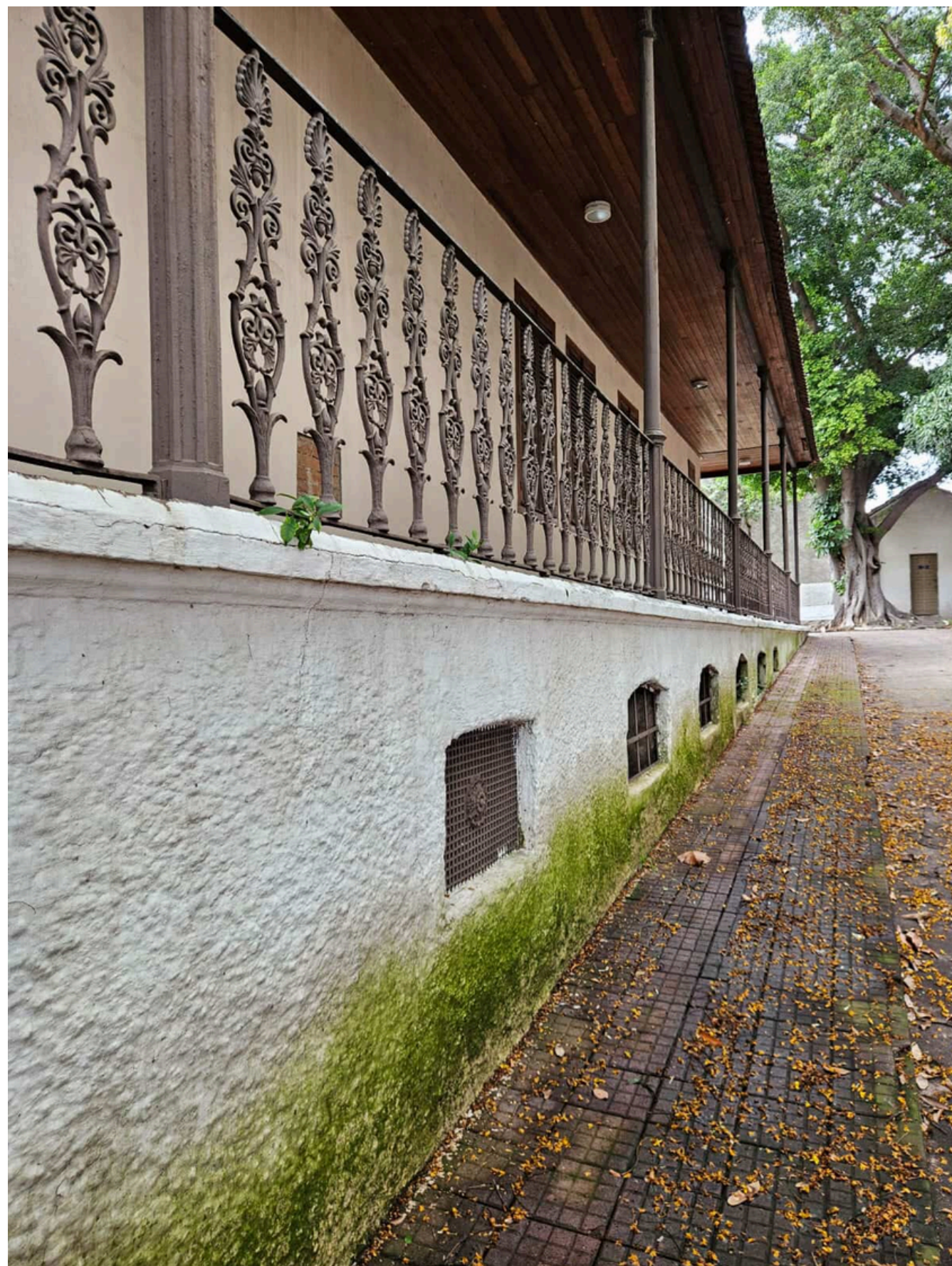
SINAIS DE UMIDADE, LODO E MUSGO
