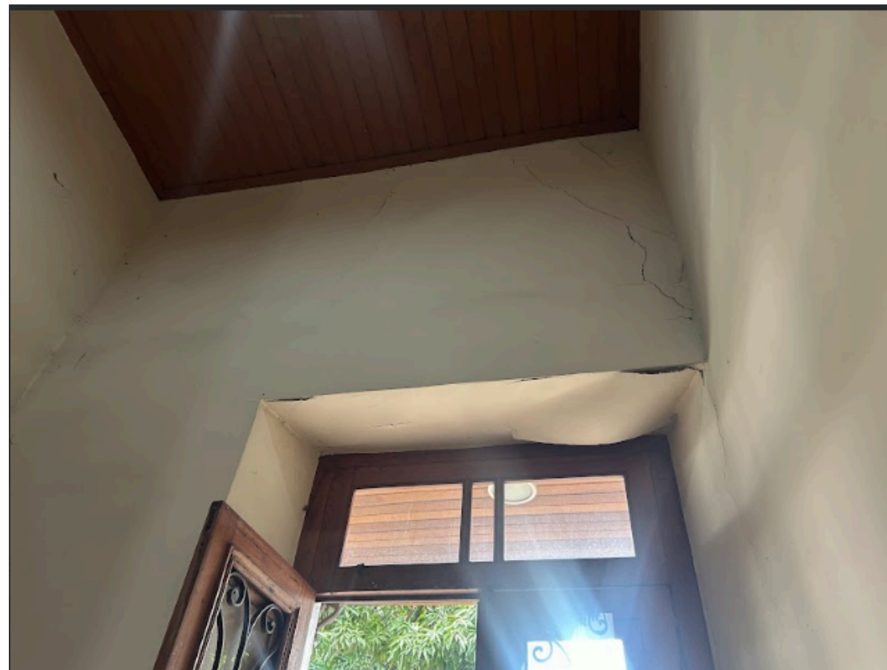
DESCOLAMENTO DA PINTURA E DO REBOCO
