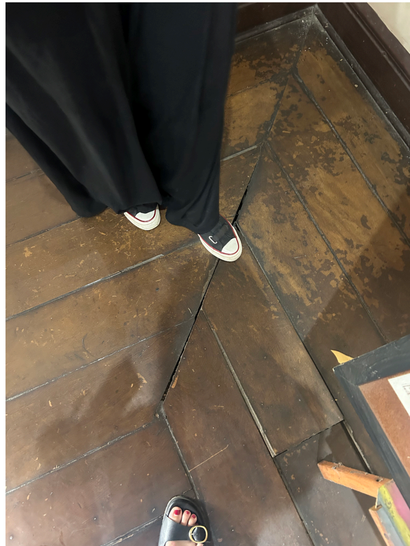
PISO DE MADEIRA DESCOLANDO NO PRIMEIRO PISO
