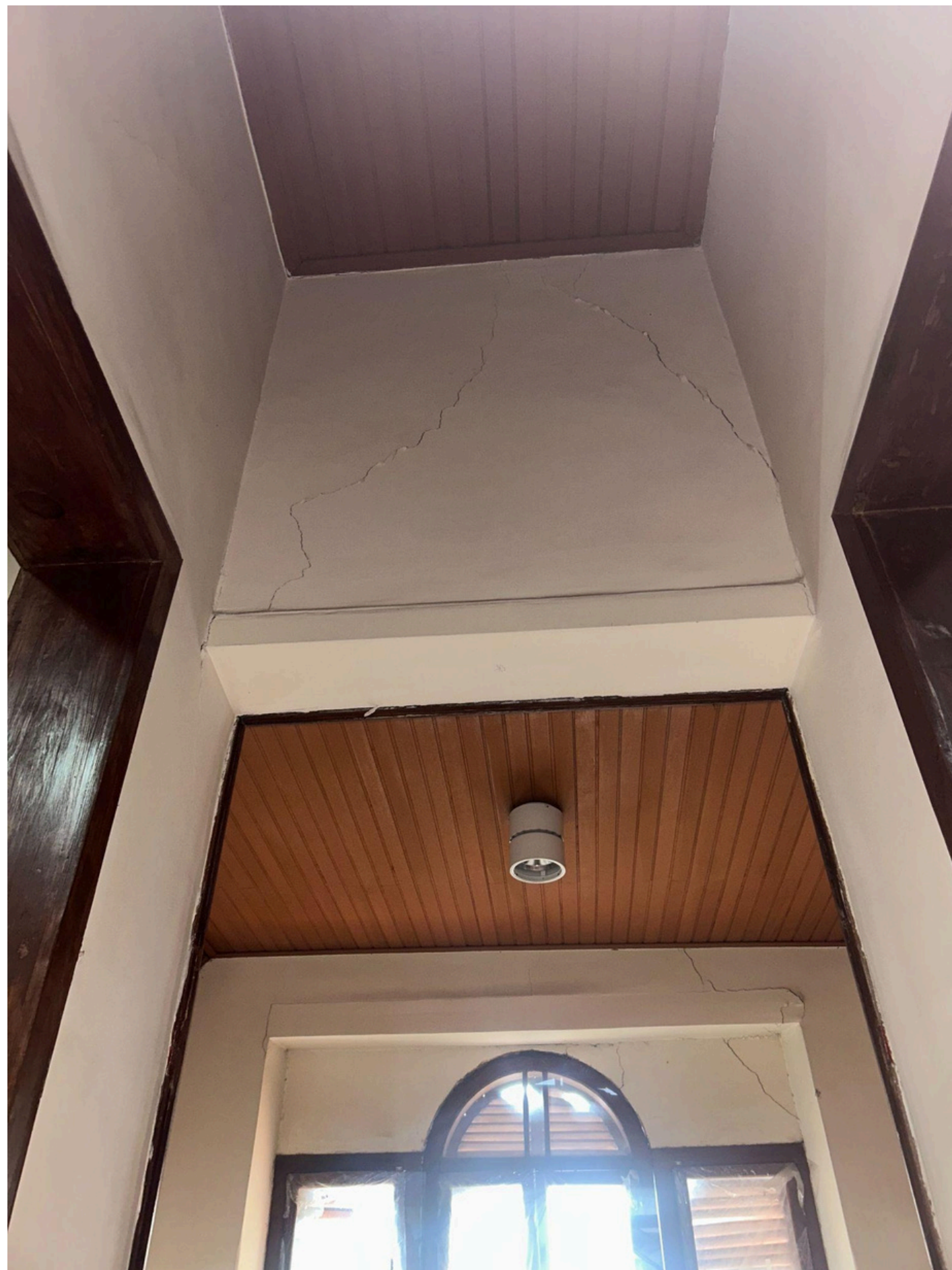
FISSURAS ESTRUTURAIS NO SEGUNDO PISO
