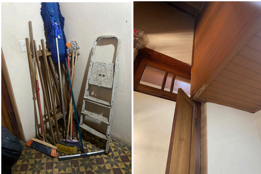
Imagens 28 e 29 - Antiga reserva técnica nas dependências do Chalé. Na imagem 20 é possível ver o rebaixamento da escada que impede a abertura da porta.
