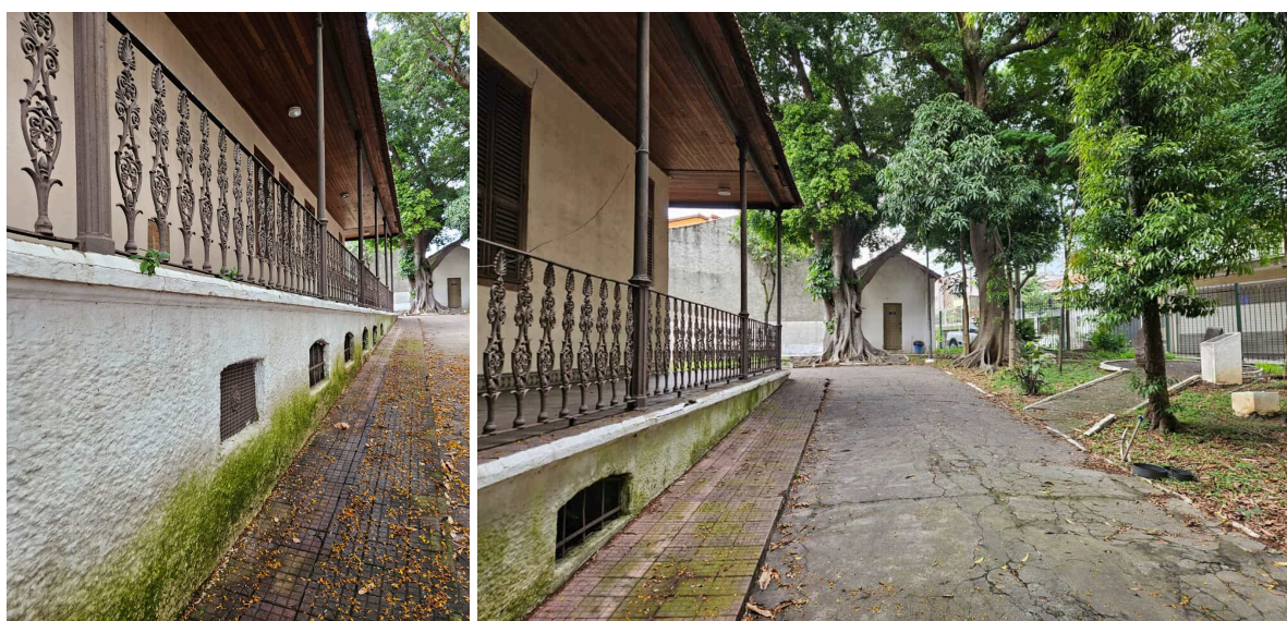
Imagem 10 e 11 - Fotografias da área externa do Chalé, como foco para os sinais de lodo na parte inferior do edifício.
