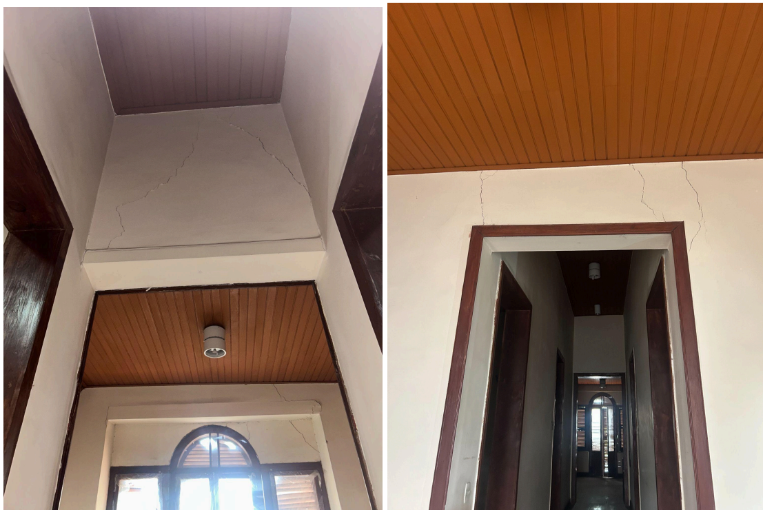
Imagens 22 e 23 - Fissuras estruturais na parte superior das entradas das salas e corredores, no segundo andar
