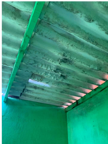
Figura 12 – Telhado com telhas deformadas e buracos, visto do interior.
