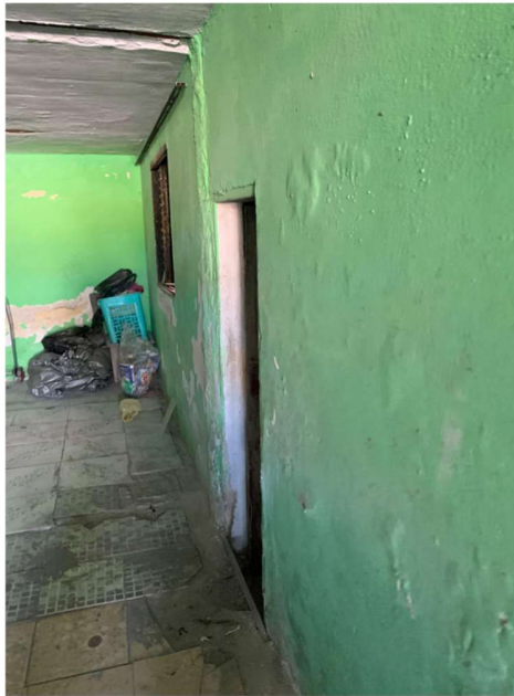
Figura 9 – Parede com mofo, bolhas e pintura desgastada.
