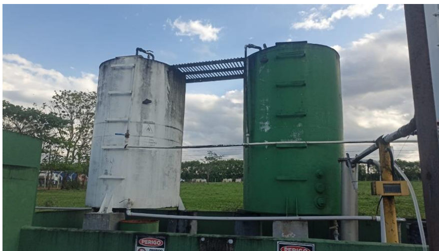
Figura 16 – Reservatório de aço inox
