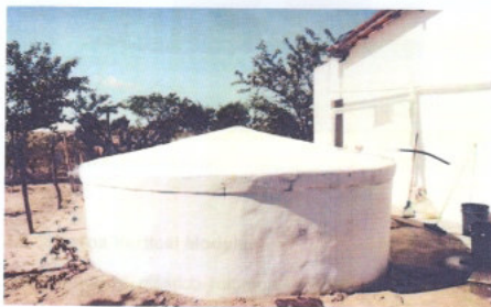
Figura 5: Cisterna de alvenaria
