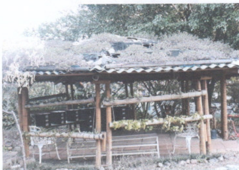
Figura 3: Fotografia tirada em 20/07/2018 antes da intervenção do grupo, com objetivo de mostrar a estrutura danificada existente no local.
