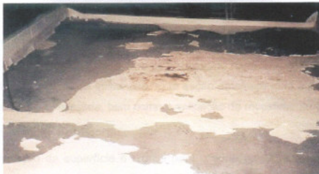
Figura 15 - Preparação de Superfície Inadequada - White Book "Surface Preparation"
