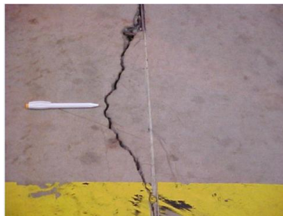
Figura 2: Tipo de fissura
