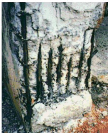
Figura 3: Corrosão em pilar
