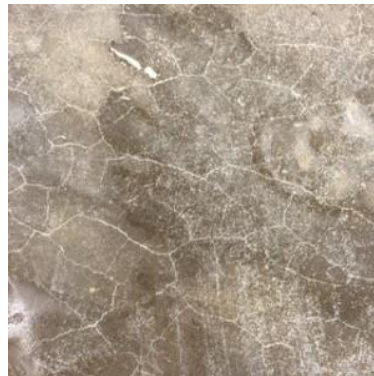
Figura 1: Detalhe de microfissuras
