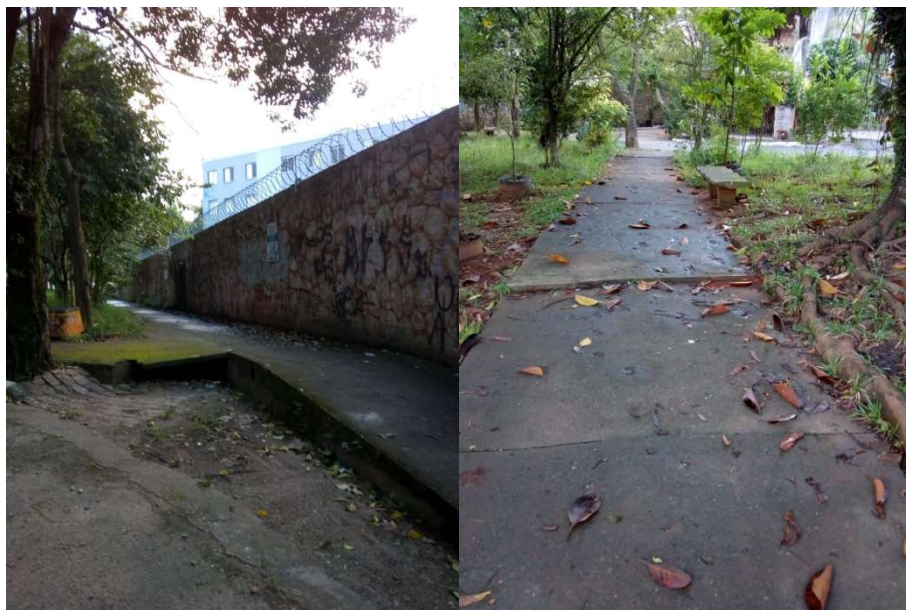
Figura 21: irregularidade nos passeios
