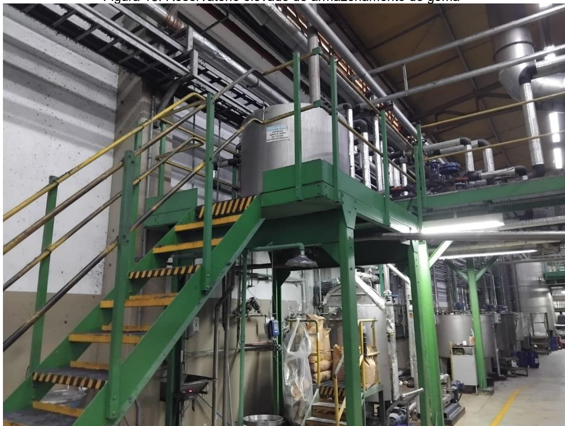
Figura 18: Reservatório elevado de armazenamento de goma
