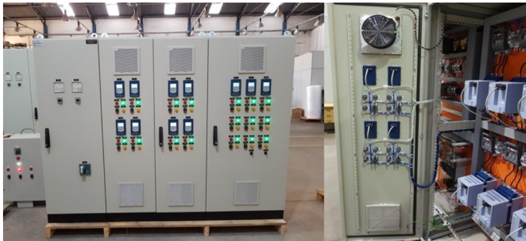
Figura 6 — Painéis elétricos - Multi Drive
