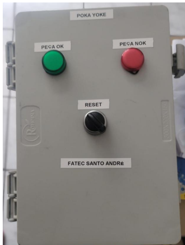
Figura 21 – Parte frontal do painel elétrico.
