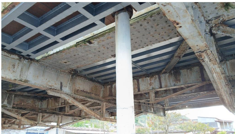
Figura 15 - Corrosão abrangente na estrutura inferior da ponte.
