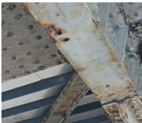
Figura 17 - Perda de seção na mesa inferior da transversina.
