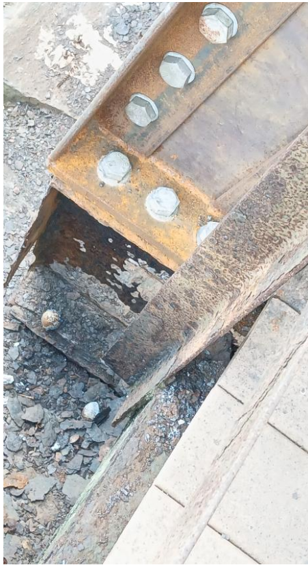
Figura 21 - Perda de seção no pórtico.
