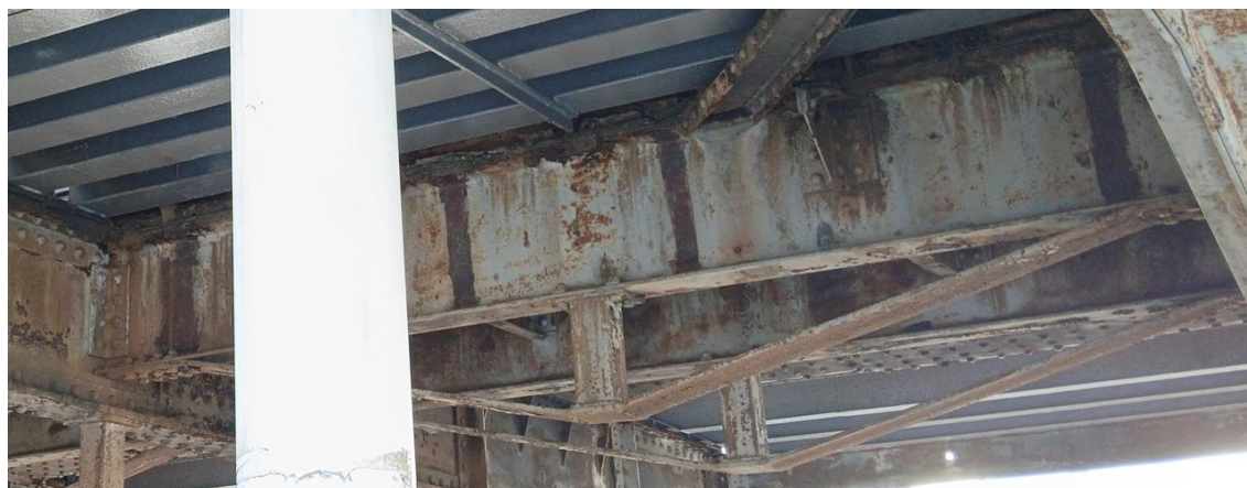
Figura 18 - Corrosão generalizada na alma da longarina central.
