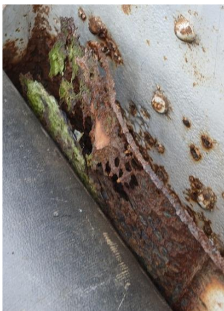
Figura 20 - Perda parcial da chapa de proteção lateral do pórtico.
