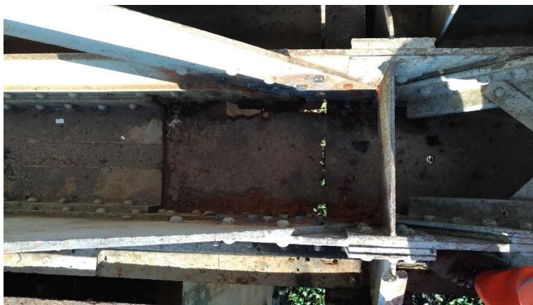
Figura 24 - Perda de seção no banzo inferior.
