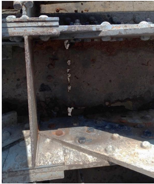
Figura 25 - Perda de seção no banzo inferior.
