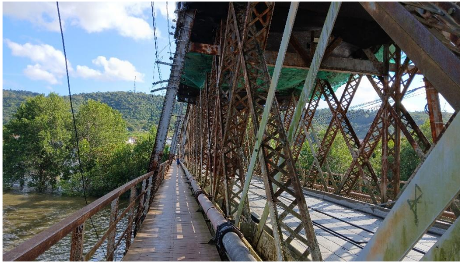
Figura 13 - Corrosão generalizada nas treliças e na transversina superior.
