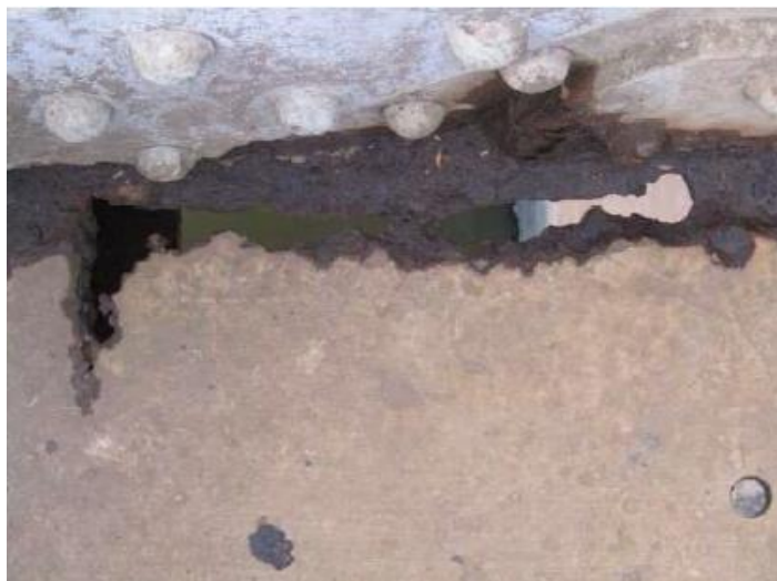
Figura 10 - Perda de seção na parte inferior da treliça devido à corrosão.
