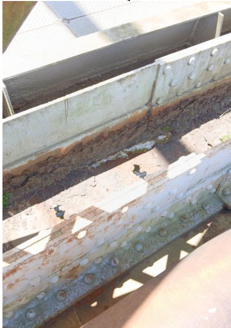
Figura 23 - Perda de seção no banzo inferior.
