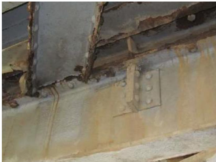
Figura 9 - Corrosão significativa próximo ao fim da ponte.
