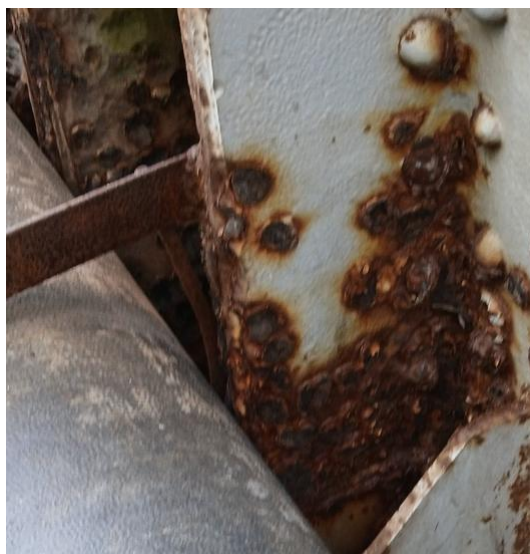
Figura 19 - Degradação de rebites do pórtico.
