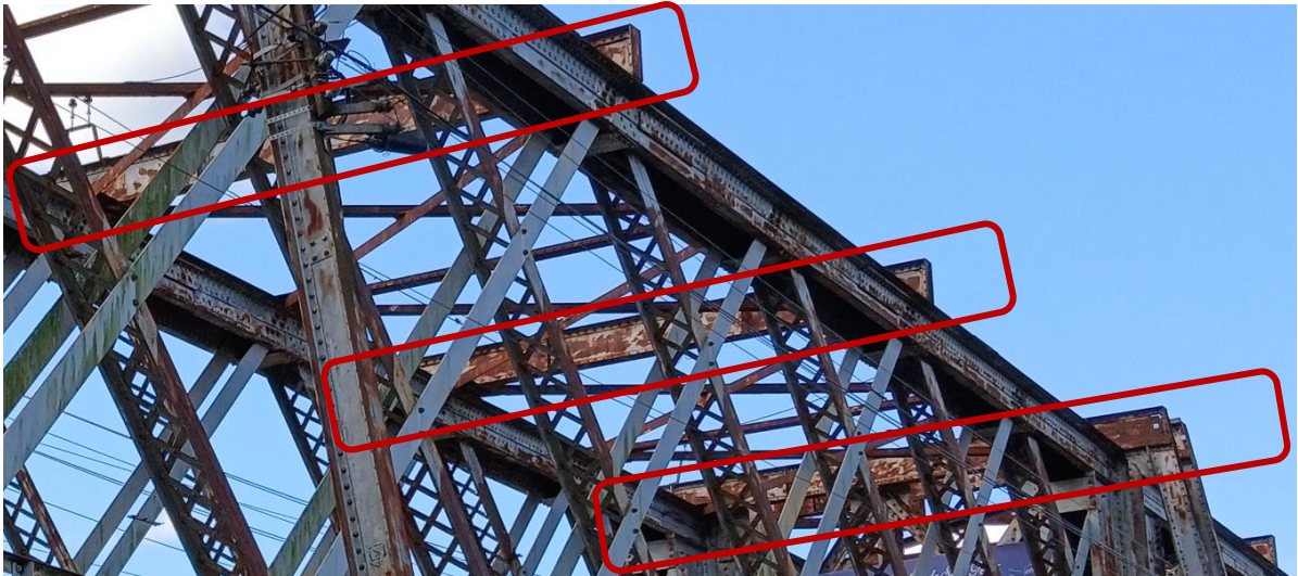
Figura 14 - Corrosão difusa nas terças superiores.
