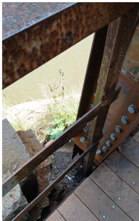
Figura 22 - Perda de seção no pórtico.
