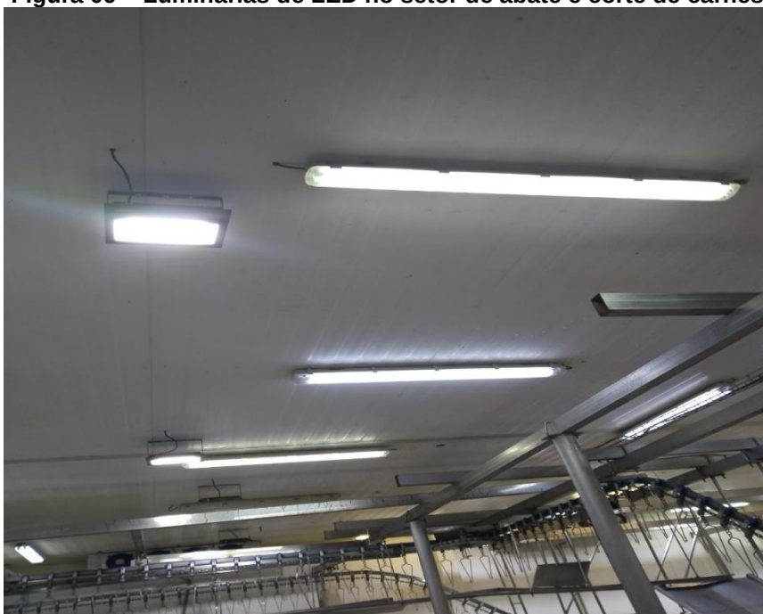
Figura 09 – Luminárias de LED no setor de abate e corte de carnes
