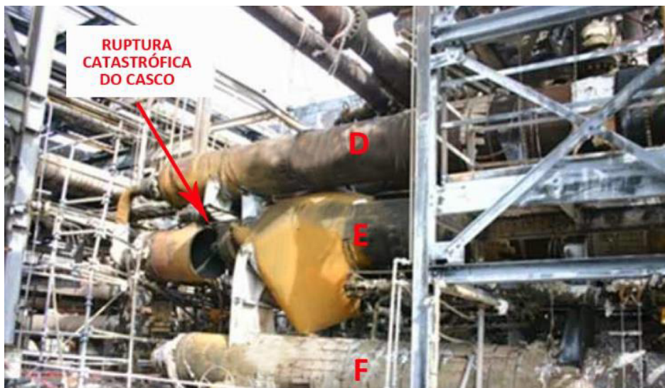
Figura 10 – Ruptura catastrófica casco do trocador de calor.
