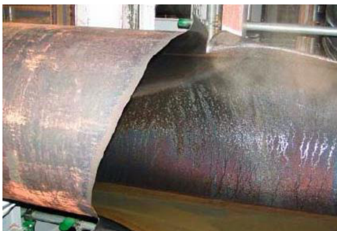
Figura 9 – Falha em tubulação devido a corrosão erosão.
