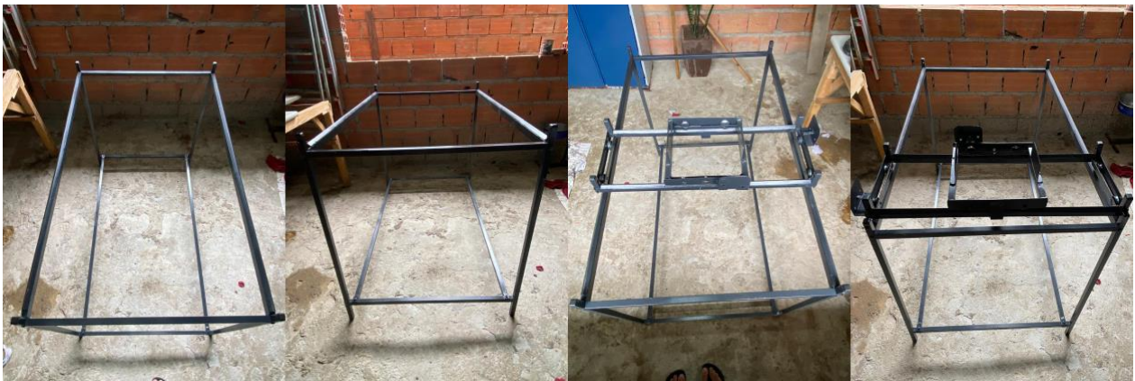
Figura 9 – Estrutura mecânica da ponte rolante após ajustes e montagem final.
