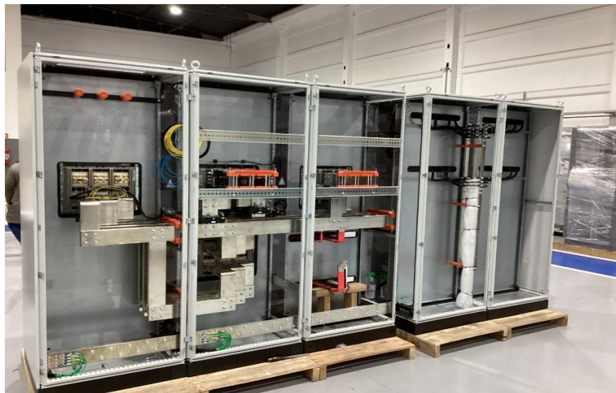
Figura 3 - Aplicação de barramentos de cobre de até 1/2 polegada em painéis de potência industriais
