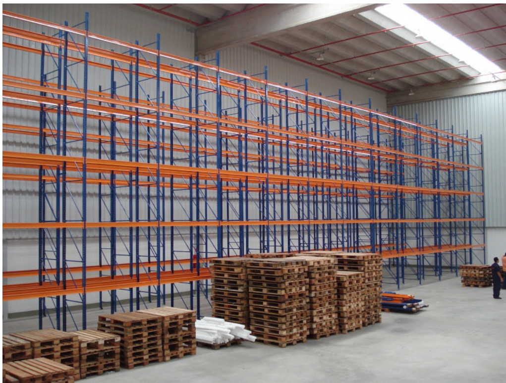
Figura 17 – Estrutura Porta Paletes
