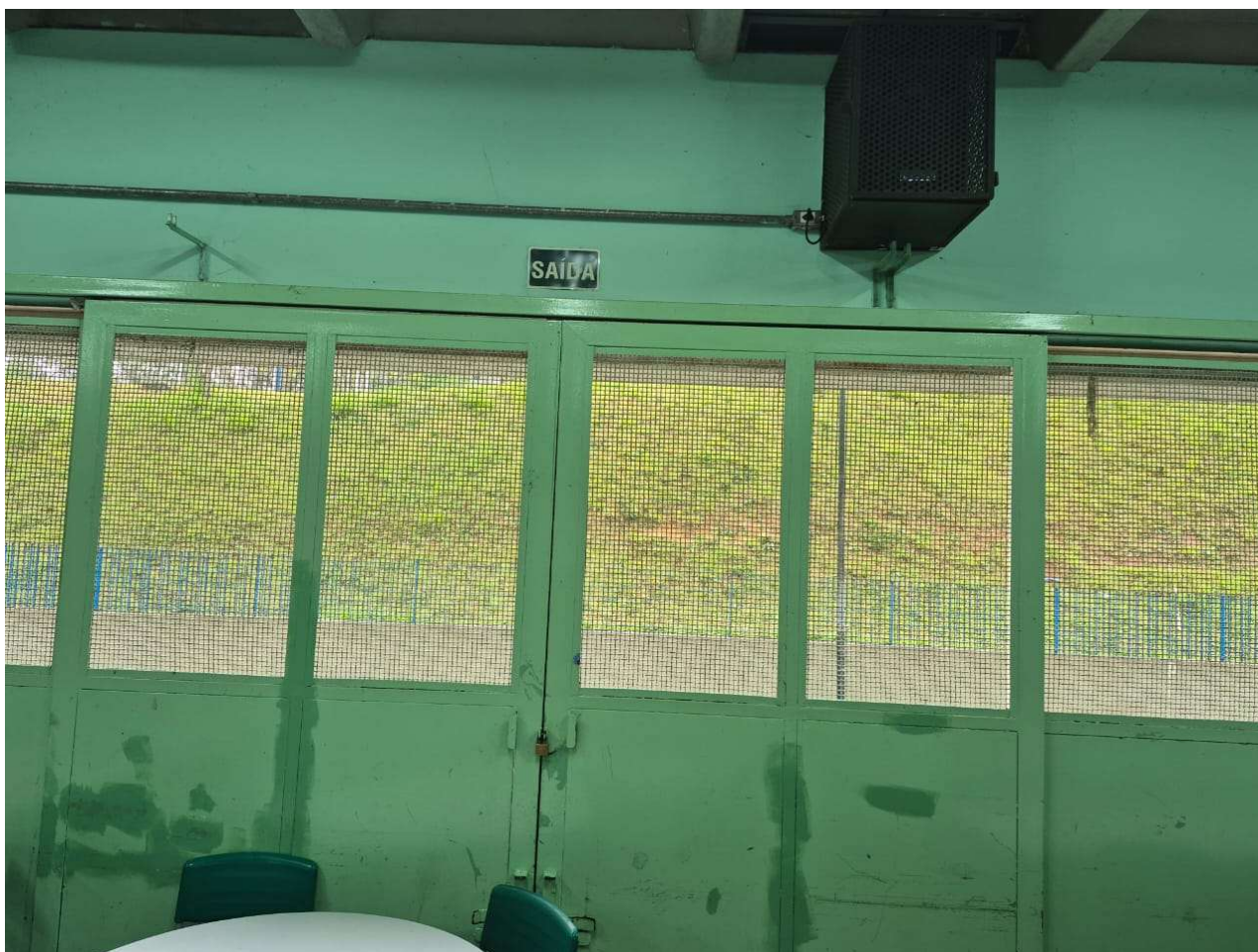
Figura 7 - Rota de fuga adicional devidamente sinalizada.
