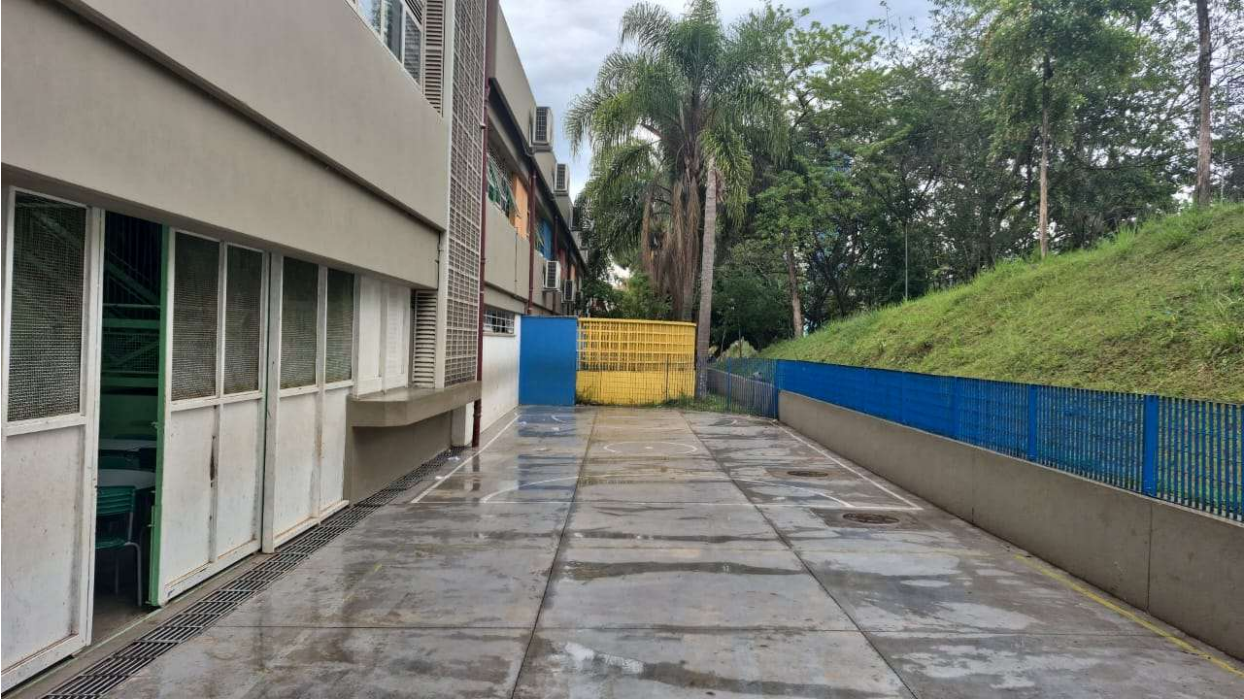
Figura 8 - Rota de fuga adicional sem portão de saída.
