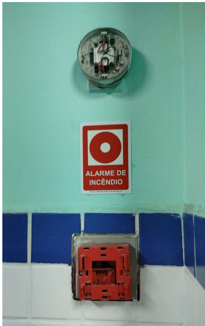
Figura 9 - Alarme de emergência do 1º pavimento inoperante.
