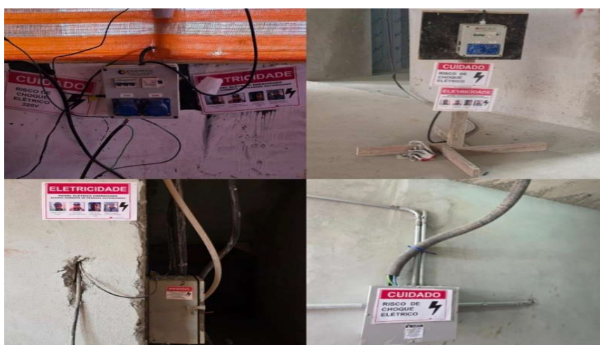
Figura11- Legenda: Instalações elétricas provisórias
