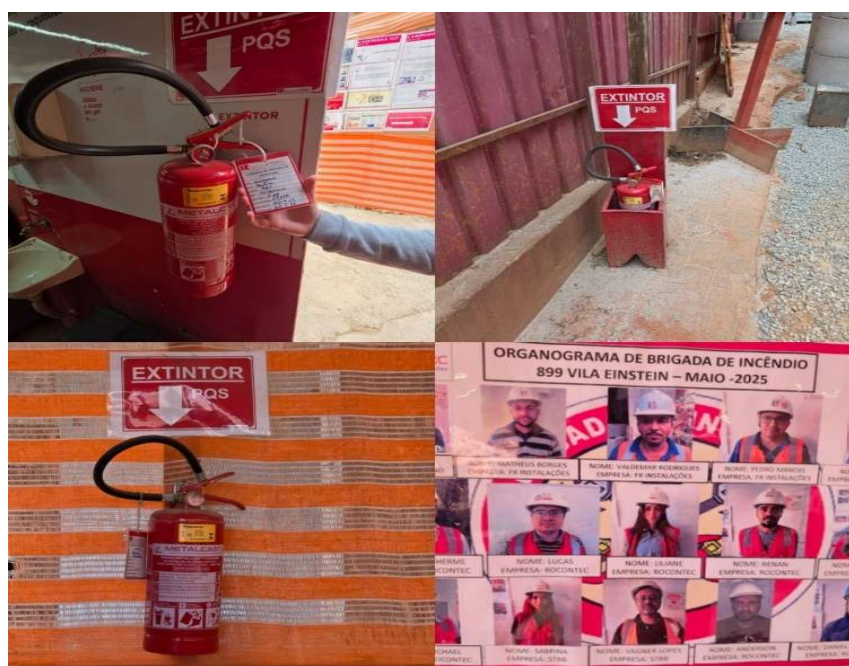
Figura12- Legenda: Proteção contra incêndio
