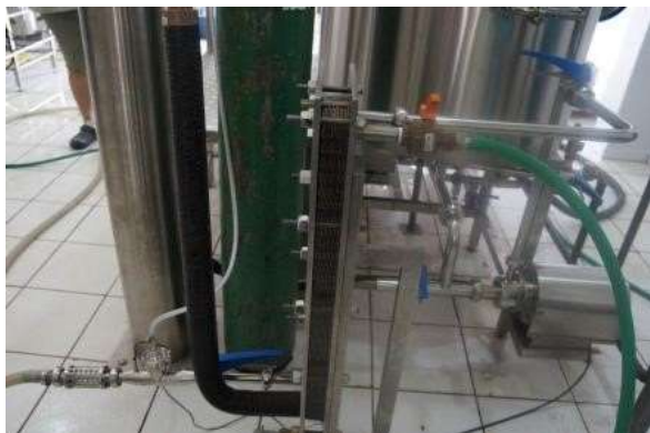
Figura 9 - Placa de transferência para o tanque de fermentação
