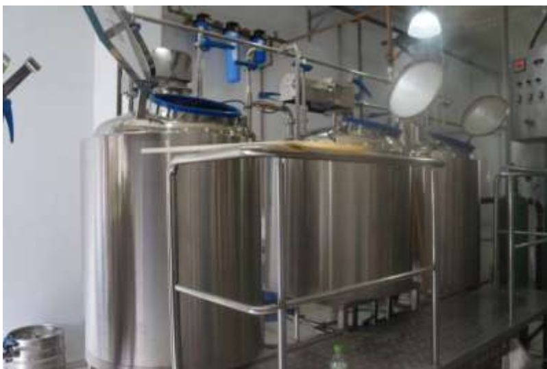
Figura 11 – Tanques de mosturação
