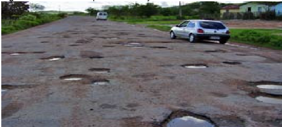
Figura 19 - Rodovia em péssima condição de uso
