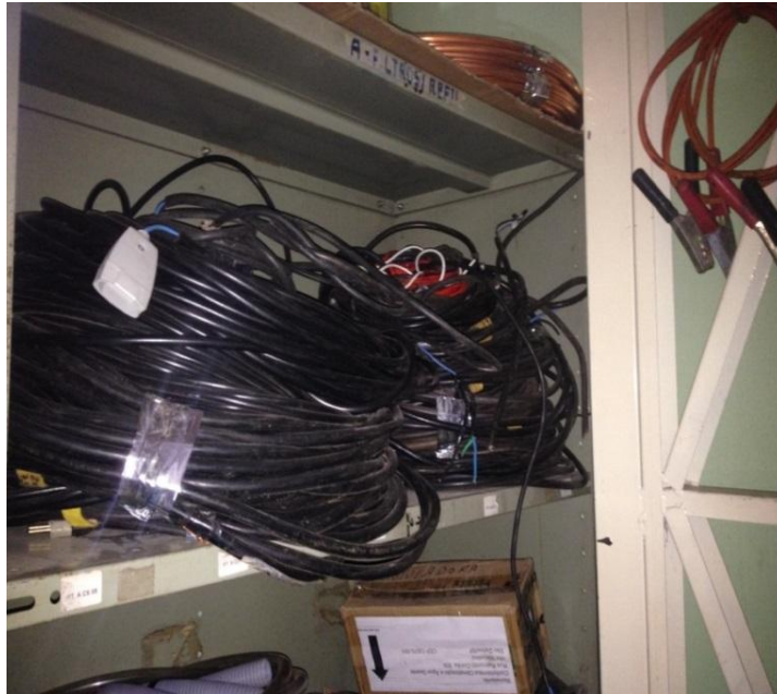
Figura 5. Organização de cabos elétricos na Alpes
