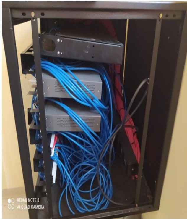
Figura 8.a – cabeamento do switch de borda
