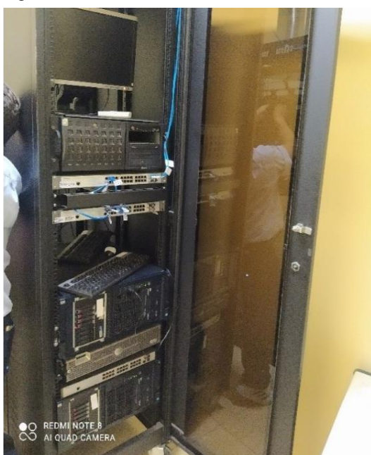
Figura 9 – Rack da sala de TI com servidores
