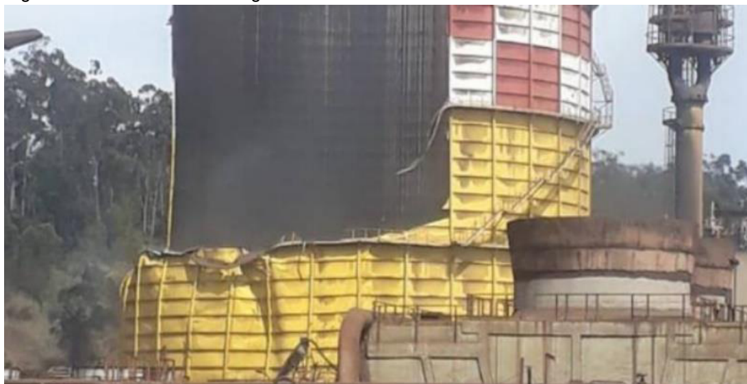
Figura 24 – Detalhe lateral do gasômetro danificado
