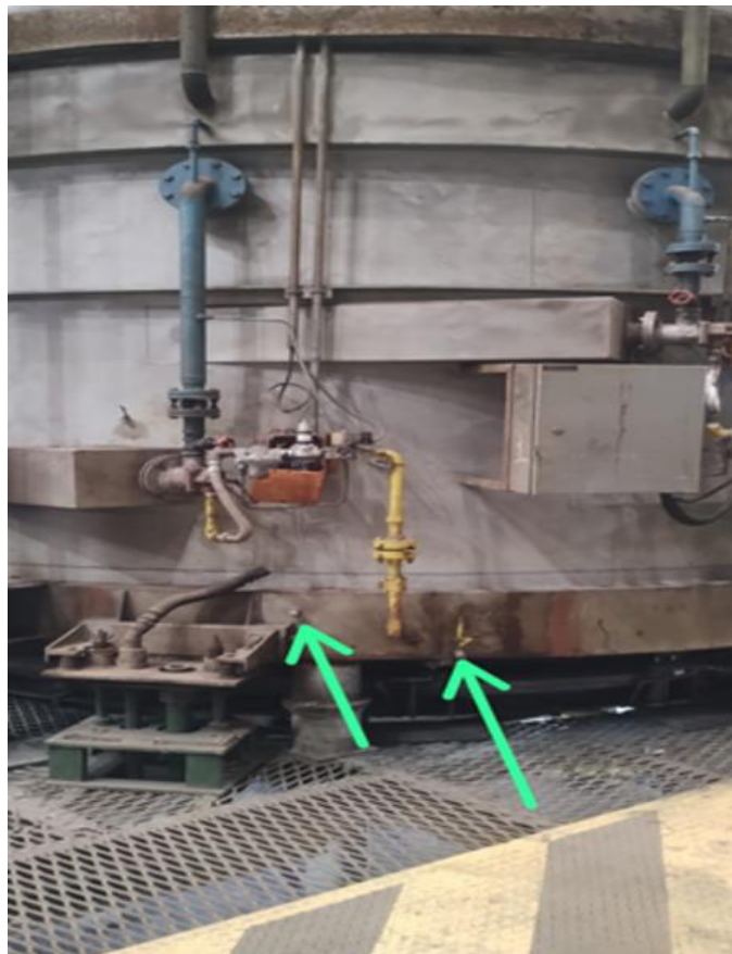
Figura 4 – Local de purga (indicado por seta verde).
