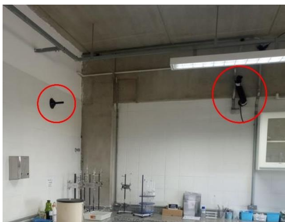
Figura 3 - Falta de ar-condicionado e ventilador no laboratório
