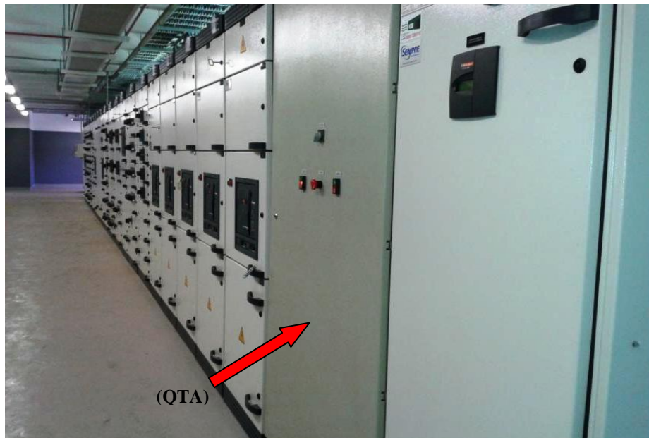
Fig. 34 – No detalhe, (QTA) Quadro de Transferência Automática (Foto Acervo Técnico do Prof. Dalbo).
