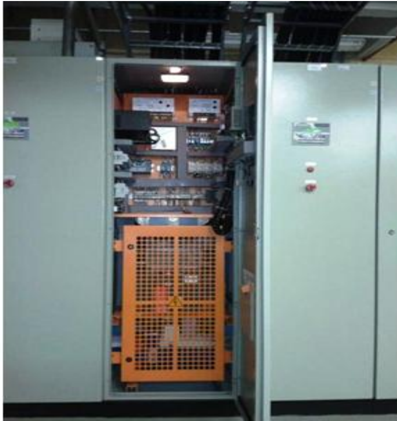
Fig. 41 – Vista Interna do Quadro do Controlador (USCA) (Foto do Acervo Técnico do Prof. Dalbo).
