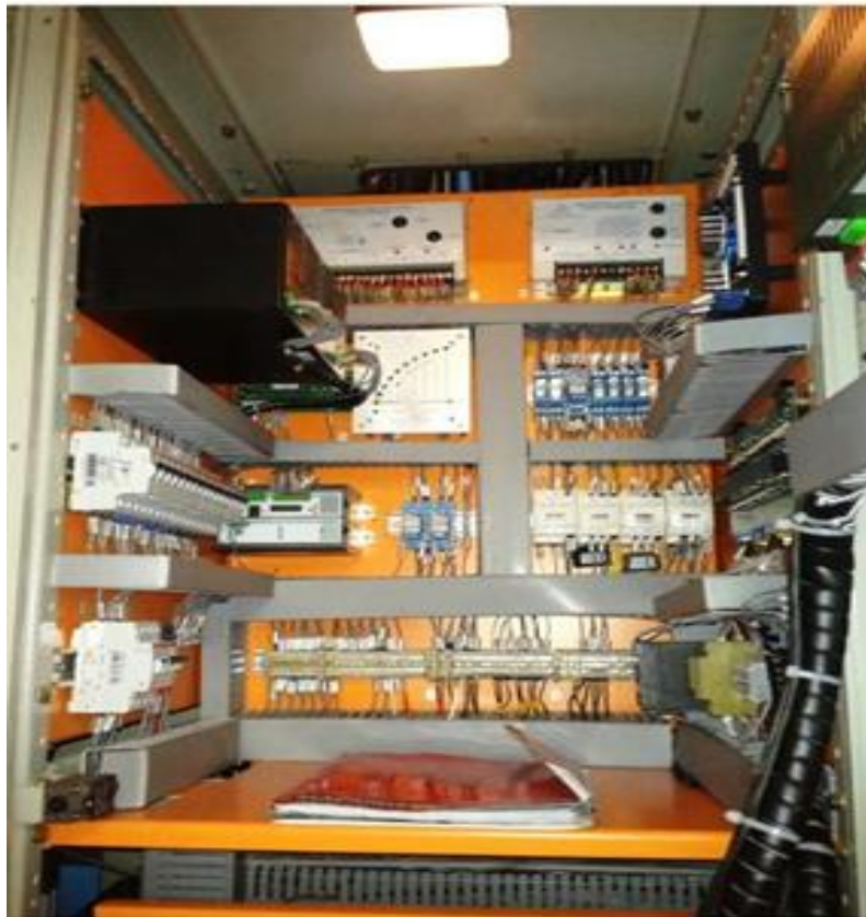
Fig. 42 – Detalhe Interno do Quadro do Controlador (USCA) (Foto do Acervo Técnico do Prof. Dalbo).
